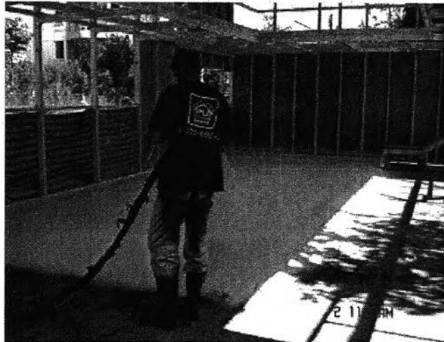
รูปที่ 3.20 แสดงการฉีดพ่นฉนวน โฟม PU กันความร้อนบริเวณพื้น
